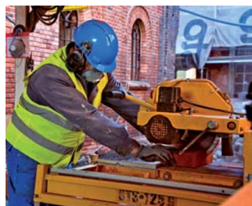
Przy mechanicznym cięciu należy zakładać maskę ochronną, ochronniki słuchu i okulary ochronne.
